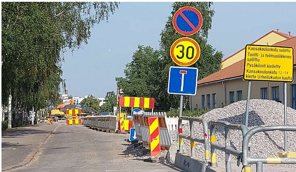
Kuvissa Juholankadun peruskorjausta vuodelta 2022. Peruskorjaukset herättävät myös runsasta keskustelua. Remontti muuttaa katujärjestelyjä pitkälle ajalle. Peruskorjaus on kuitenkin tarpeen teknisten järjestelmien uusimiseen. Samalla katutilaa järjestellään ja siitä tehdään kestävämpi.
